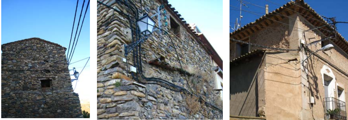
Tendidos eléctricos en Añón de Moncayo y Mallén.
