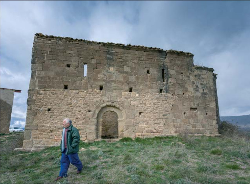
Exterior de Ceñito, en el que se aprecia cómo sus muros aguantan mientras su cubierta está arruinada por completo.
