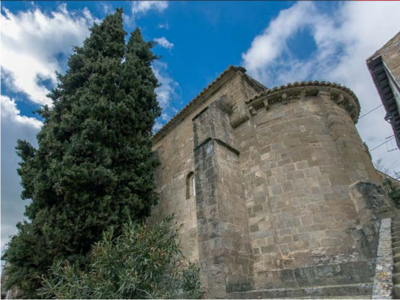
El ábside exterior de la iglesia no se vio transformado en la reforma del siglo XVI.
